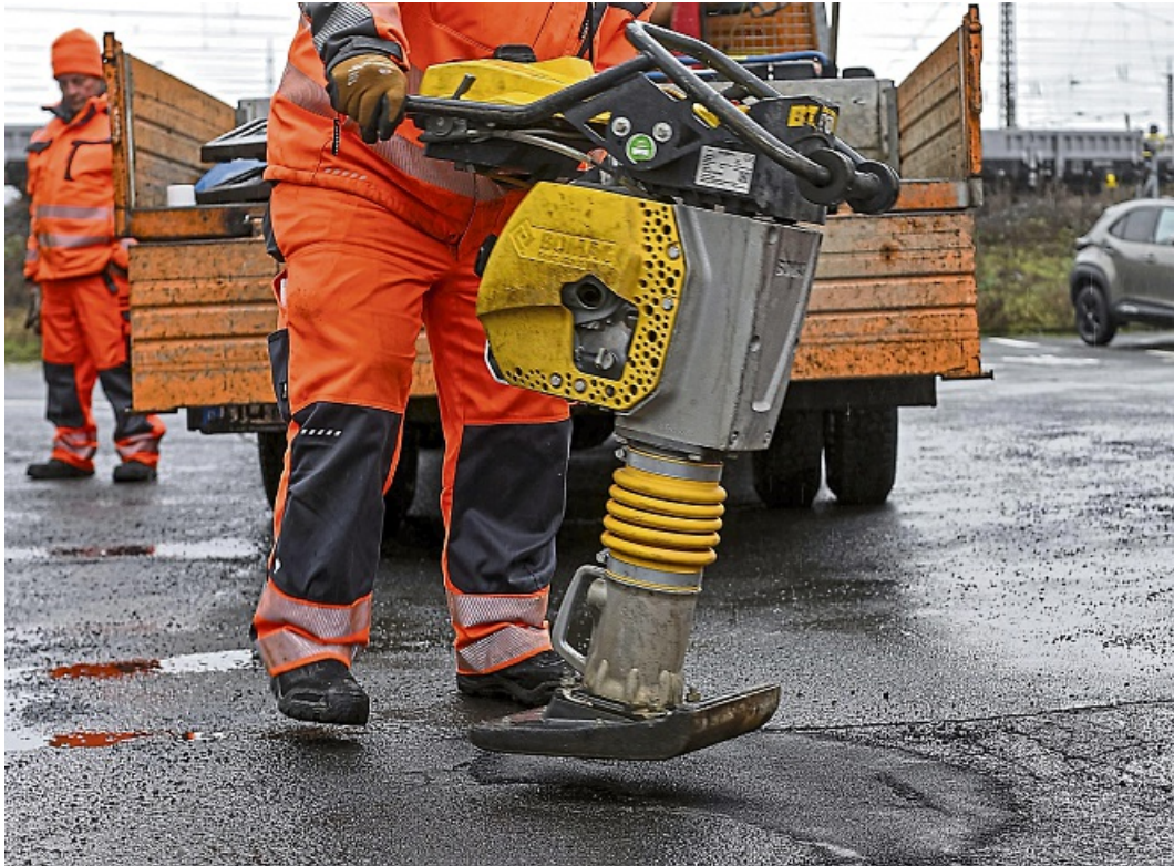
Als Folge des Frosts sind wieder zahlreiche Schlaglöcher entstanden. Der städtische Bauhof ist derzeit mit zwei Teams für Reparaturen unterwegs. STADT HANAU
